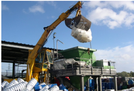
Ligne de recyclage d'emballages souillés – Chargement par grappin
